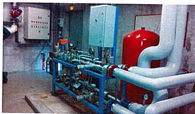
Exemple d'une sous-station
