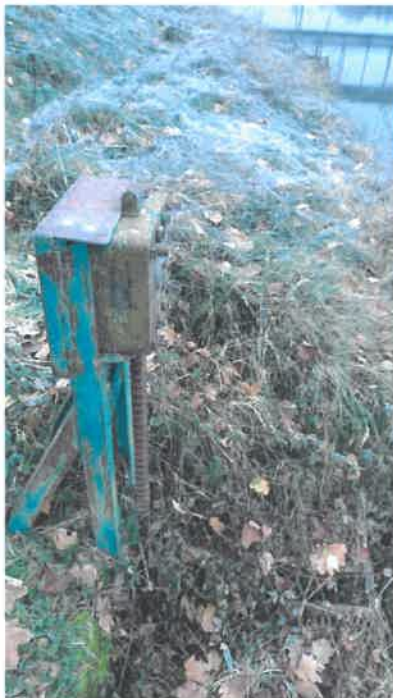
Photo 3 : dispositif de manœuvre de la vanne de l'ouvrage traversant
